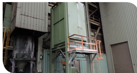
一號窯新增消石灰噴注設備
