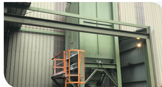
二號窯新增消石灰噴注設備
